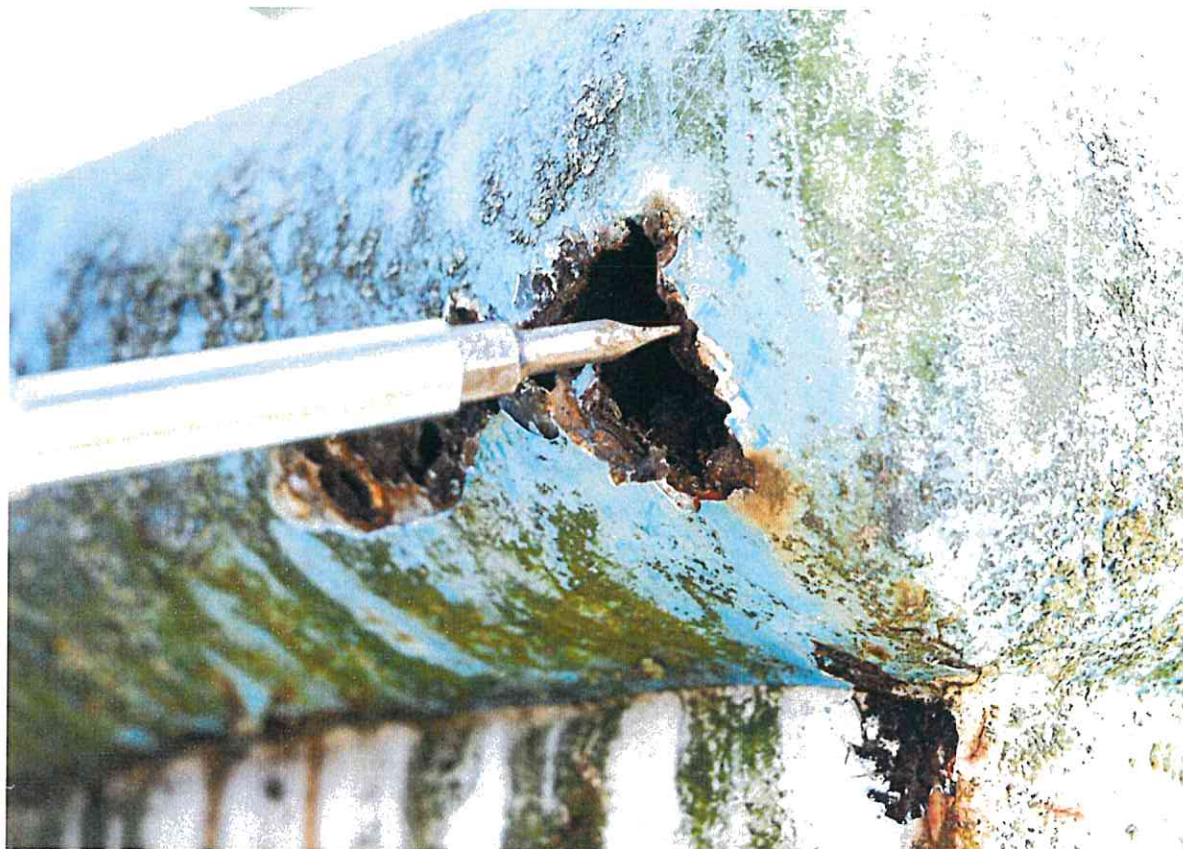
Fig. 13 Detaliu cu oxidări ce au dus la perforări, și alte degradări (depuneri, scurgeri, deg. biologice).
