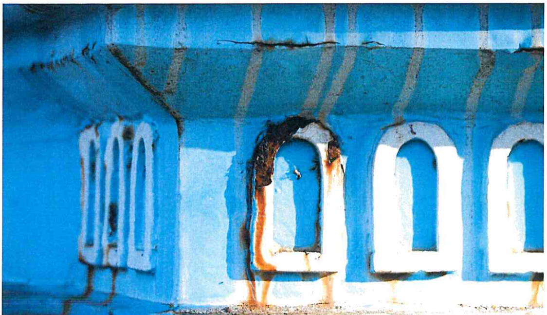
Fig.16 Detalii cu diverse zone afectate de degradări.
