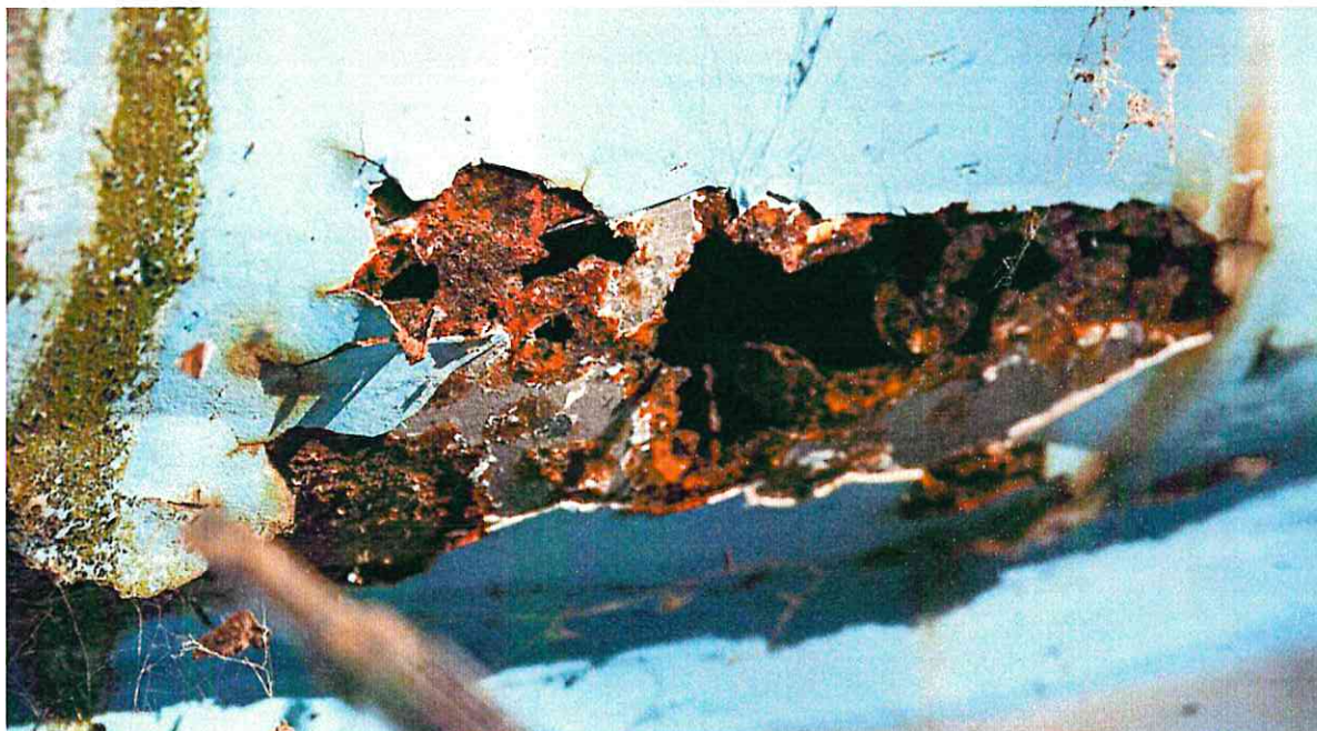
Fig.11 Oxidări ale tablei ce au dus la distrugerea completă a materialului metalic.
