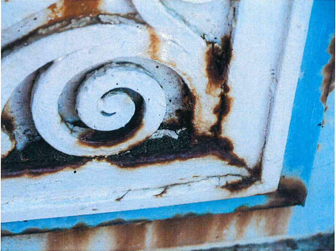
Fig.15 Detalii cu diverse zone afectate de degradări.
