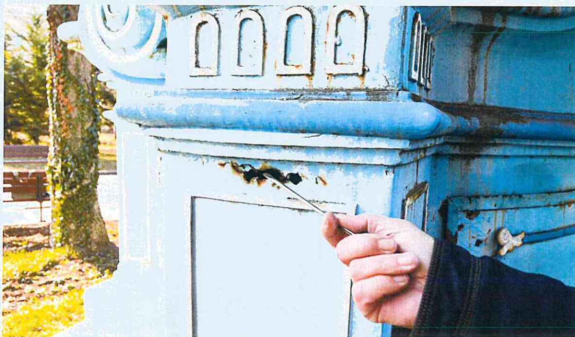
Fig.10 Oxidări ale tablei ce au dus la distrugerea completă a materialului metalic.
