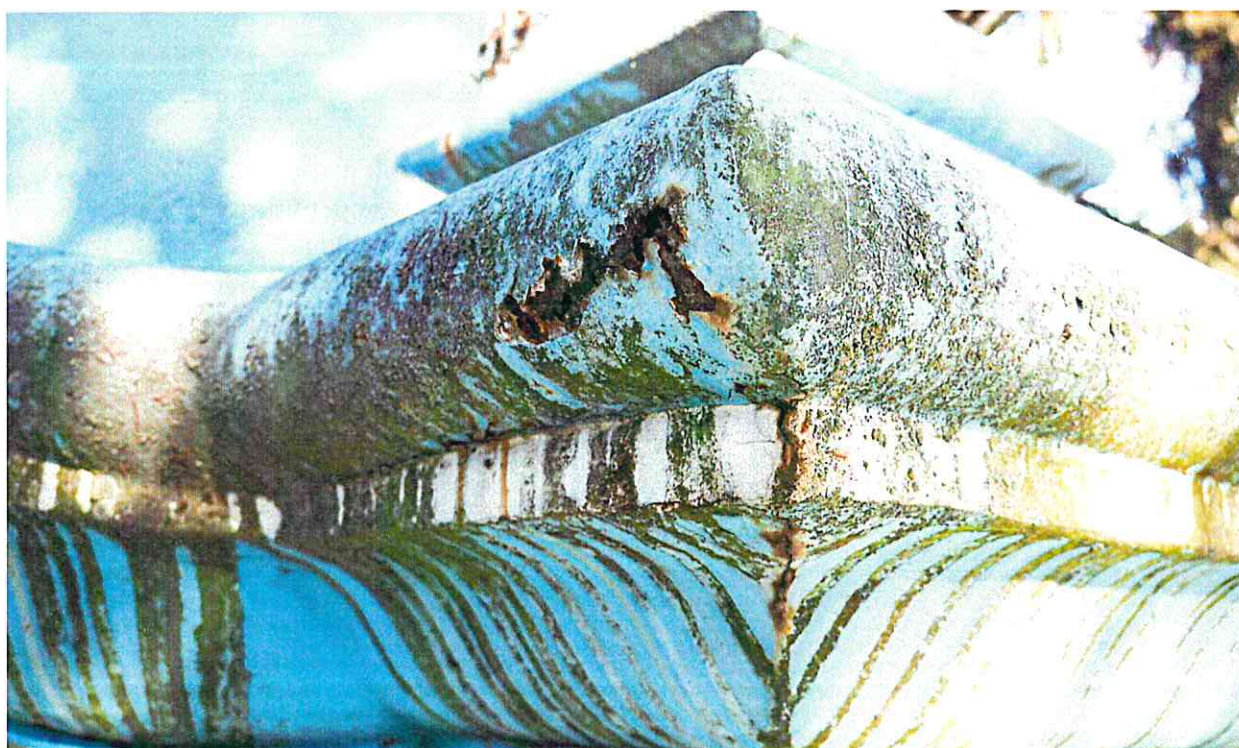
Fig. 12 Detaliu cu oxidări ce au dus la perforări, și alte degradări (depuneri, scurgeri, deg. biologice).
